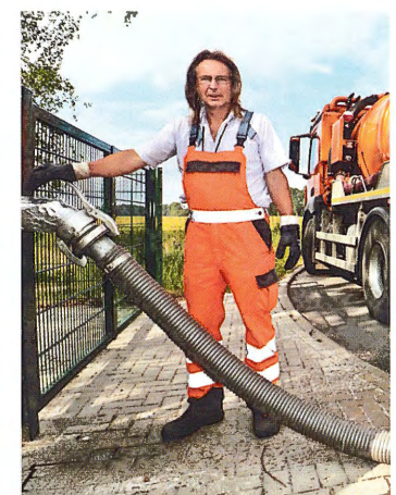
Wolfgang Hinz beim Abpumpen des Schmutzwassers aus dem Fäkalfahrzeug in die Sommerfelder Einlassstelle, von wo aus es per Druckleitung zur Kläranlage gelangt.
